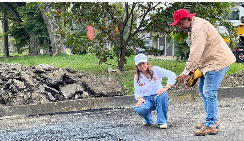
Luz Adriana Vásquez Trujillo, secretaria de Infraestructura de Cali, supervisando las obras de mejora de una carretera en Cali
